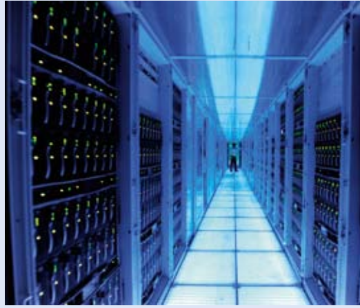
SAP: Blick in einen Serverraum
