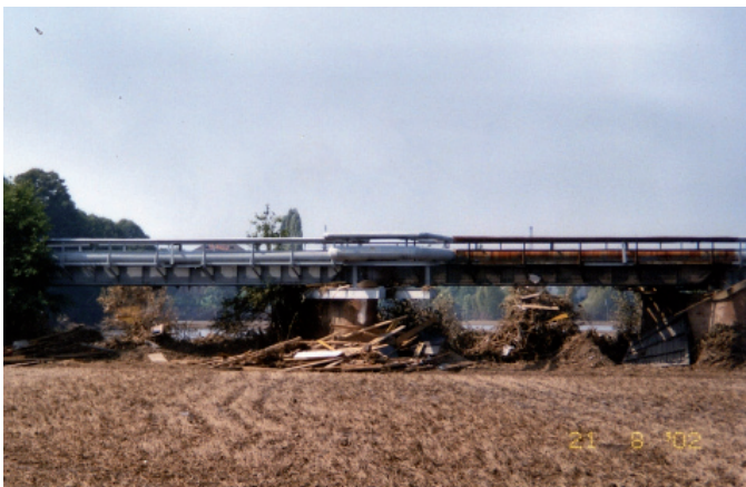
Die Eisenbahnbrücke nach dem Hochwasser 2002 Bildquelle: Landeshauptstadt Dresden, Umweltamt, 2002
