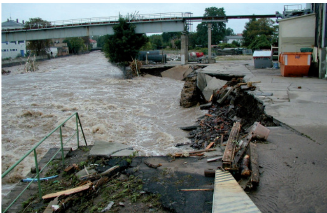
Die zerstörte Ufermauer Bildquelle: Maschinen- und Stahlbau Dresden GmbH, 2002
