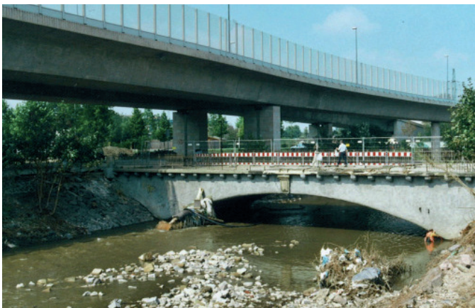
Schäden an der Brücke nach dem Hochwasser Bildquelle: Landeshauptstadt Dresden, Umweltamt, 2002
