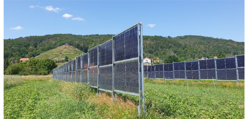
Agri-Photovoltaik-Versuchsanlage der HTW in Pillnitz, Foto: LHD
