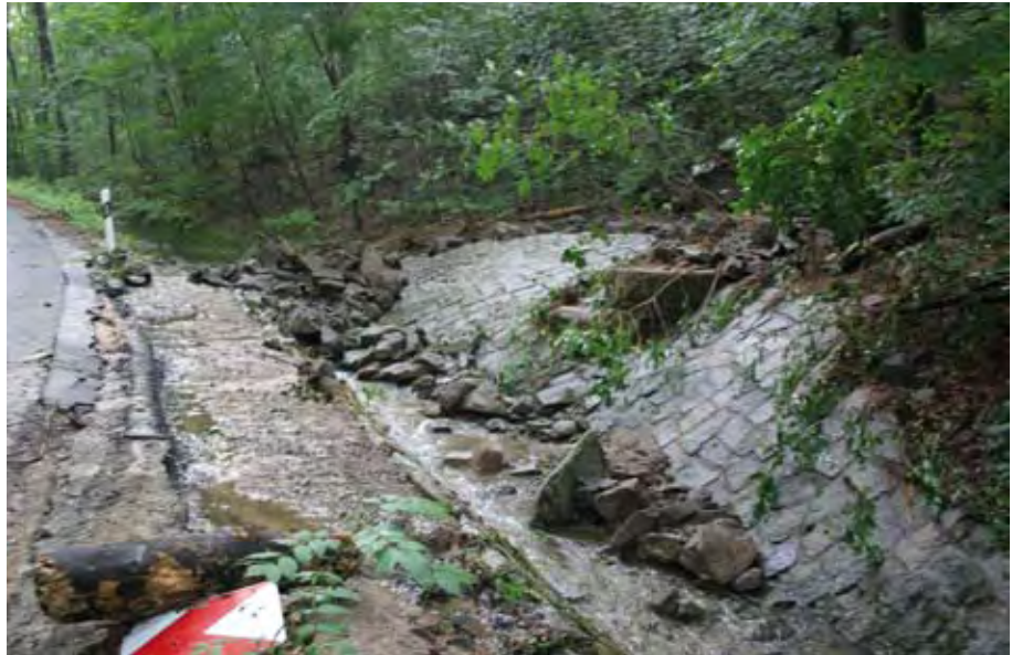
Abb. 5.23: Zerstörungen am Bachbett und Geschiebeablagerungen nach Sturzflut am Helfenberger Bach
