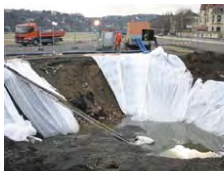
Abb. 5.44: Käthe-Kollwitz-Ufer, Einbruch Altstädter Abfangkanal 2. April 2006 (Quelle: SEDD GmbH)
