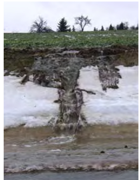
Abb. 4.3: Erosion nach Schneeschmelze und Starkregen im Februar 2006 in Kaitz
