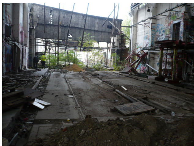
Bild 1: ehemaliges Produktionsgebäude, z.T. eingestürzt, 2010
