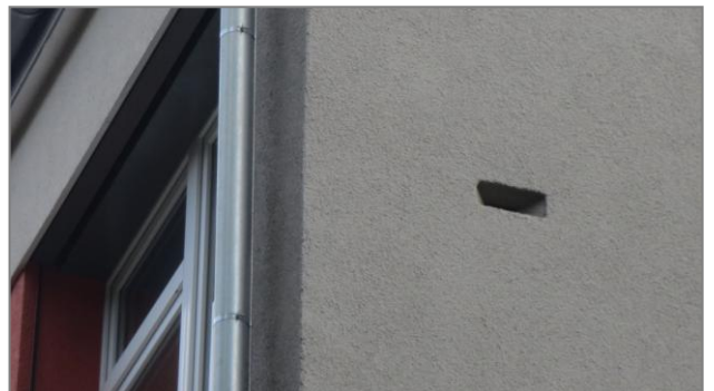
Fledermaus-Winterquartier in die Wärmedämmung eingebaut
