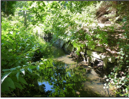
Abb. 2: Vor der Maßnahme: wilder Uferverbau aus Betonplatten, 30.07.2020
