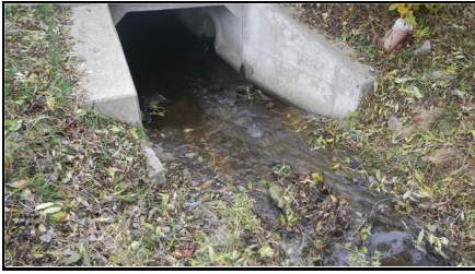
Abb. 3: Vor der Maßnahme: schwer passierbarer Durchlass am Auenweg, 09.11.2017
