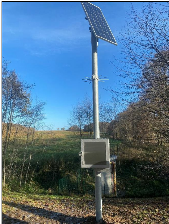
Abb. 1: Solarmast mit Messschrank, 01.12.2022
