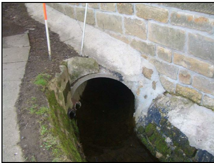
Abb. 3: Einlauf in Durchlass Alte Schmiede, 20.04.2006
