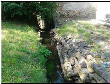
Abb. 2: Desolater Uferverbau am Lausenbach (IST-Zustand), 04.07.2017
