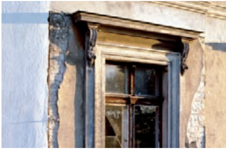
Abb. 1 Der Putz des Hauses bröckelte, Oktober 1996
