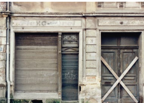
Bürgerstraße 19, Symbolbild für viele Gebäude im Sanierungsgebiet
