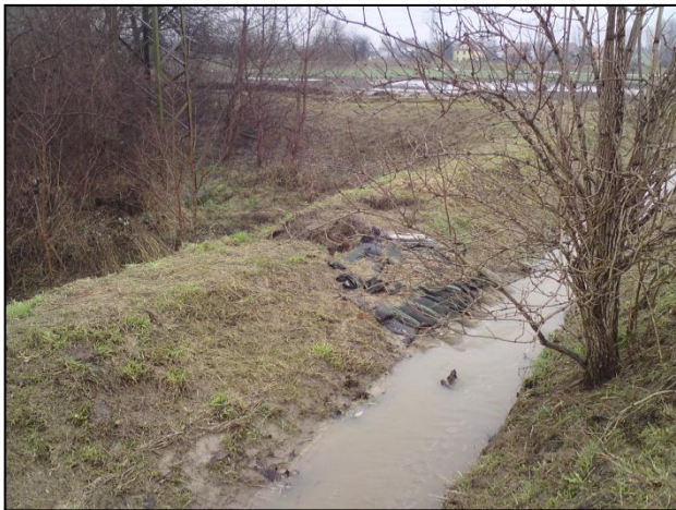
Bild 3: Schadstelle unterstrom Kleinlugaer Straße
