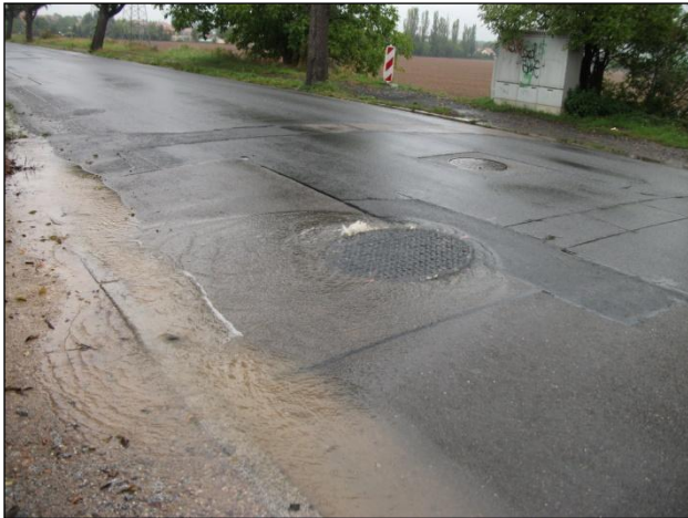
Bild 3: undichter Düker Lugaer Straße Nr.74
