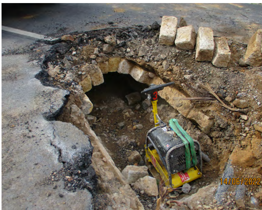
Eingebrochener Kanal im Kreuzungsbereich Orangeriestraße/Lohmener Straße in Pillnitz.
