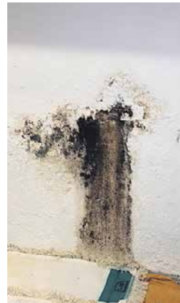
Schimmelbefall im Keller /Foto: Bausan
