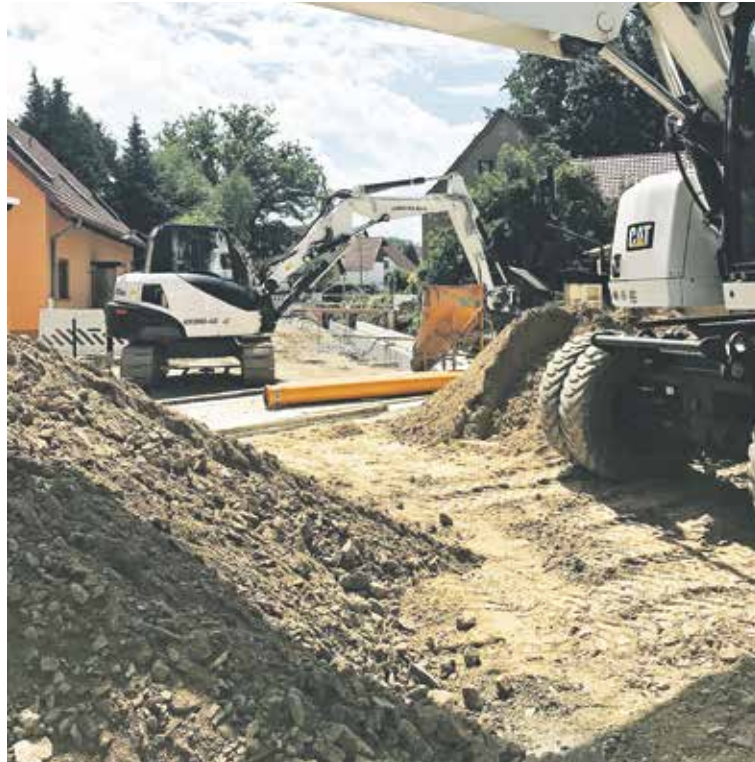
Bühlauer Straße im Schönfelder Hochland. Es entstehen ein neuer Gehweg und ein Hochwasserschutz.
