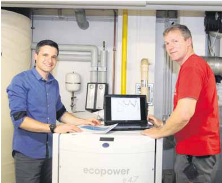
Fachgespräch. Frank Seffner und Steffen Pfeifer (von links) am Blockheizkraftwerk im Sportzentrum Blasewitz.
