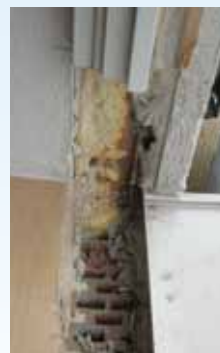
Status nach Entfernung des verfaulten Holzes
