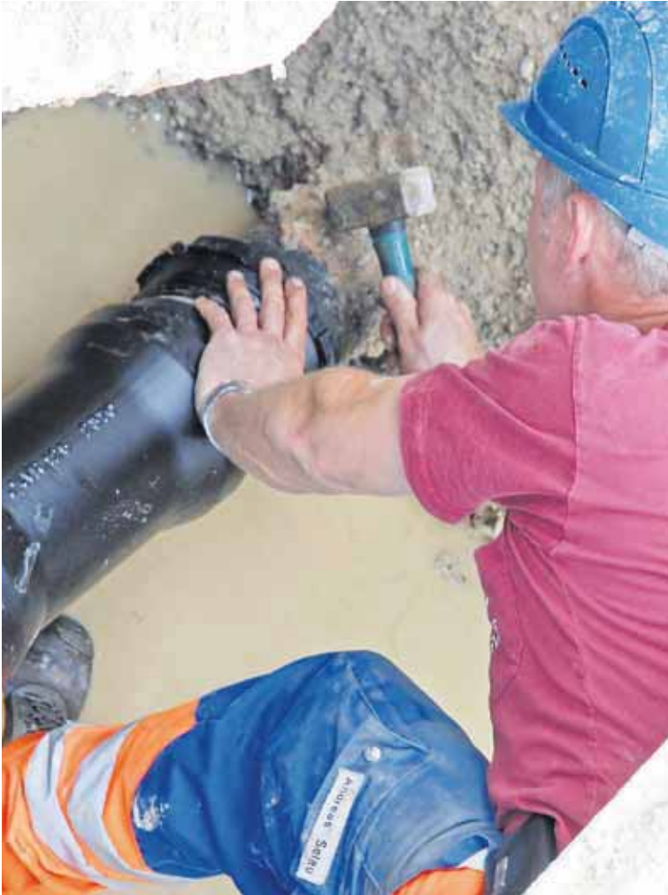
Schadensbeseitigung: Mit Instandsetzung sollte immer ein Fachmann beauftragt werden. Foto: Paul-Georg Meister | Pixelio
