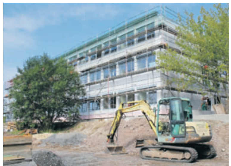
Gymnasium Klotzsche. Im Gebäude auf der Karl-Marx-Straße 44 stellen Fachleute Raumeinheiten auf. Hier investiert die Stadt insgesamt 800 000 Euro. Foto: Tino Flügel
