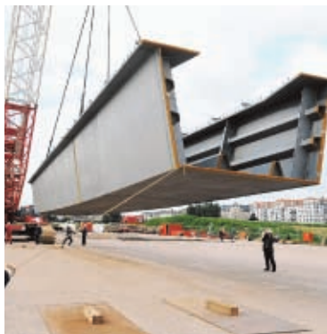
▲ Ankunft der Hauptträger. Nach langer Fahrt aus Belgien in Dresden eingetroffen. Foto: Jürgen Männel
