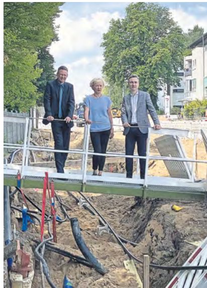
Auf der Baustelle: Baubürgermeister Stephan Kühn, Straßen- und Tiefbau-Amtsleiterin Simone Prüfer und DVB-Vorstand Andreas Hemmersbach (von rechts).
