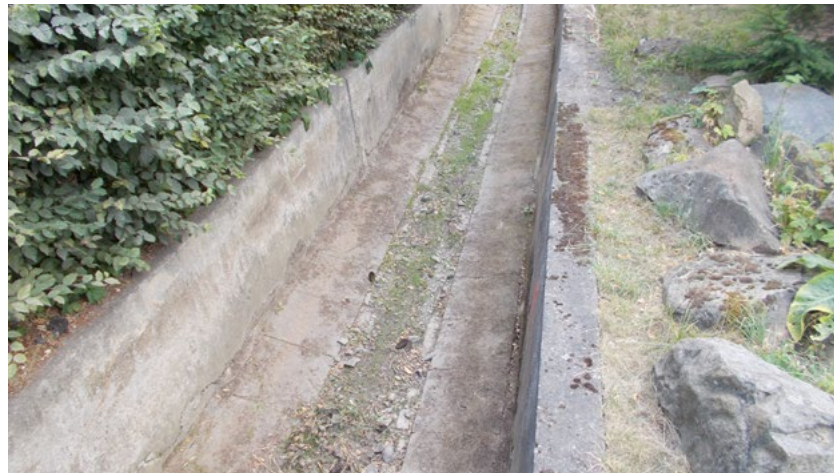
Abbildung 136: Ausgetrockneter Roter Graben in Langebrück, 10. August 2022 (Quelle: Landeshauptstadt Dresden, Umweltamt, Neumann)
