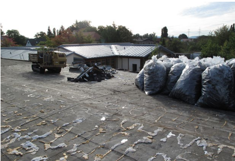
Abbildung 62: Schichtweiser Abtrag der Dachhaut (Hauptgebäude ehemalige Behindertenwerkstatt, September 2019) (Quelle: Landeshauptstadt Dresden, Umweltamt)
