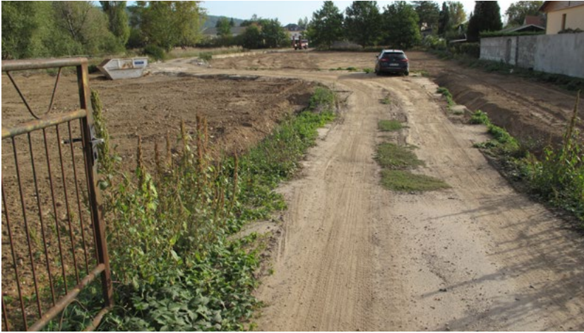
Abbildung 60 Teilmaßnahme südlich Trieske-Kiessee: Zustand nach Abbruch der Versiegelung, Bodensanierung und Bodenaustausch (September 2019) (Quelle: Landeshauptstadt Dresden, Umweltamt)
