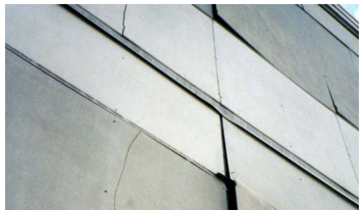
Zweifache Gefahr durch kaputte Bauplatten aus starkgebundenem Asbest
