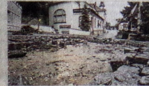
Die Weistropfer Straße bleibt gesperrt. Ein Loch macht die Weiterfahrt unmöglich. Foto: André Wirsig
