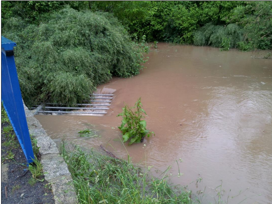
Bild 4.9 Wasserstände am Einlauf in dem verrohrten Abschnitt (Oskarstraße) des Kaitzbaches am 03.06.2013 am Gustaf-Adolf-Platz (Fotostandort 1)
