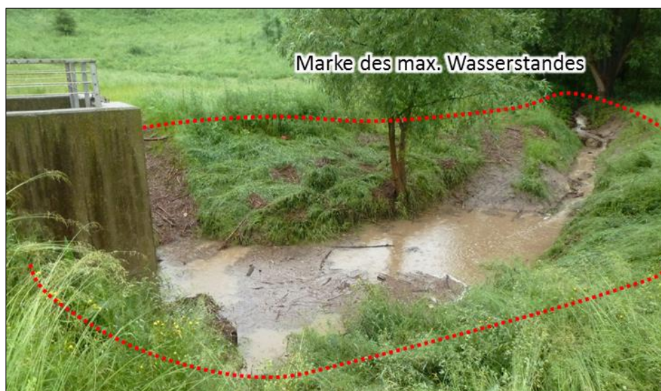
Bild 4.31 Wasserstand am HWRB Zschauke am 27.05.2014
