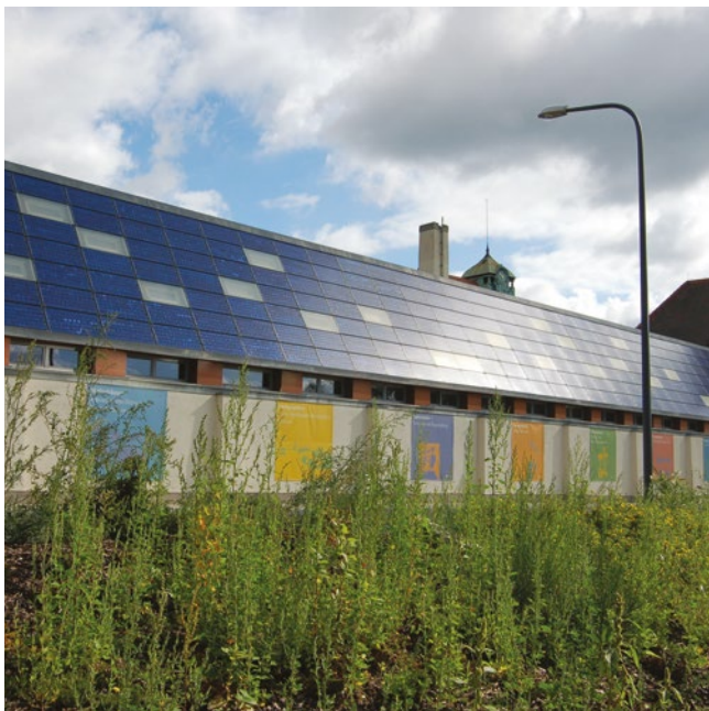
Indach-Anlage auf Süddach eines Bürogebäudes
