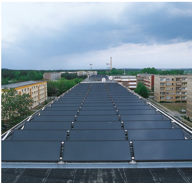
Flachkollektoren auf einem Plattenbau-Dach
