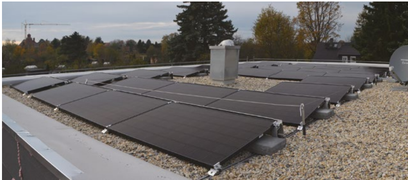
PV-Anlage in 15°-Südaufstellung auf einem EFH, die PV-Anlage ist vom Garten aus nicht zu sehen
