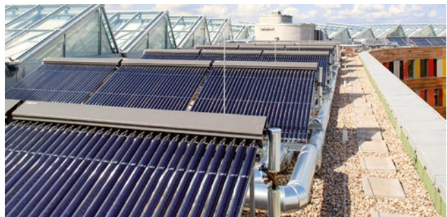
Röhrenkollektoren auf Flachdach
