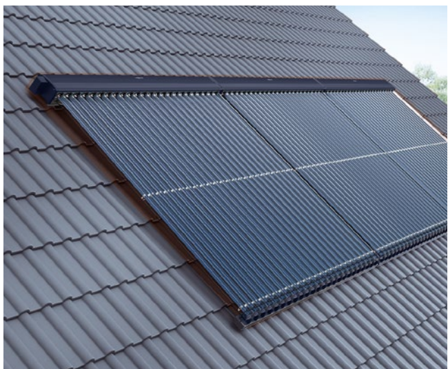
Dachparallele Anordnung eines Vakuum-Röhrenkollektors
