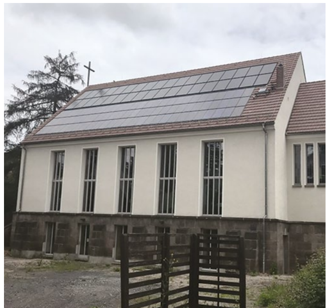
Thermische Solaranlage: Flachkollektoren auf energieautarker Kirche
