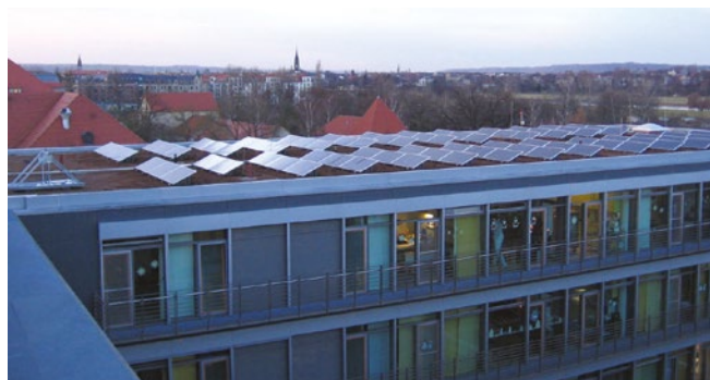
Aufdachanlage auf einem Krankenhaus
