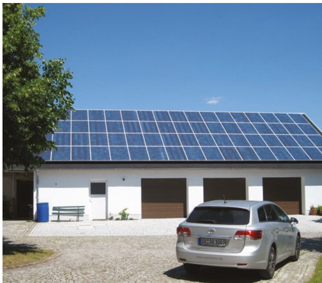
Vollflächige Aufdach-Anlage auf einem Satteldach
