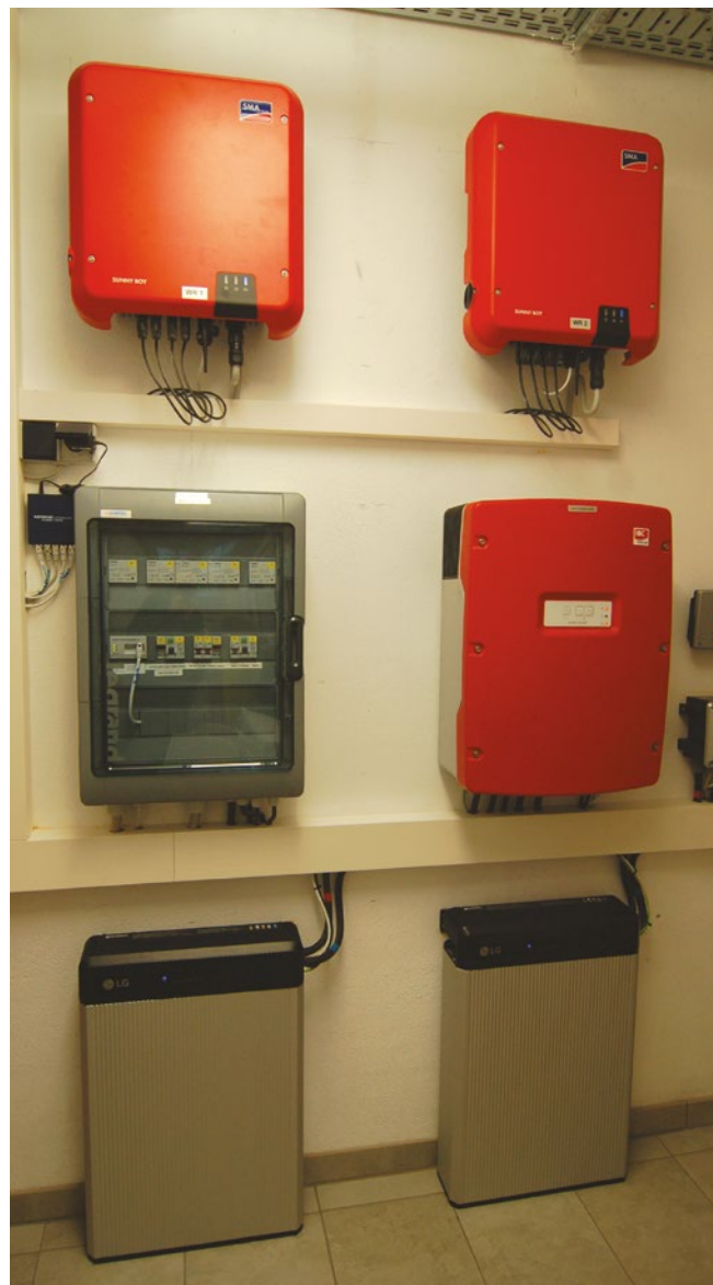
Platzbedarf für Wechselrichter und Solarstrom-Speicher im EFH
