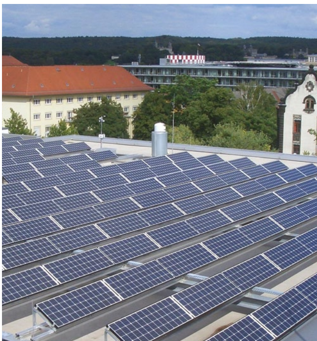
Flachdachanlage mit 30°-Aufstellung
