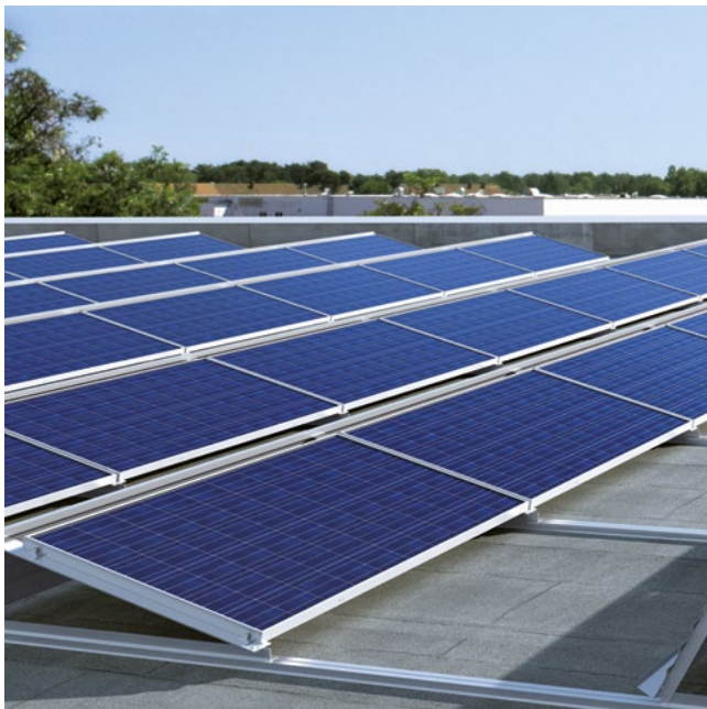
Flachdachanlage mit 15°-Aufstellung
