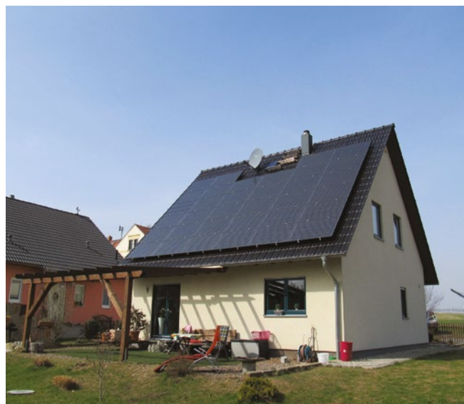
Aufdachanlage auf einem EFH
