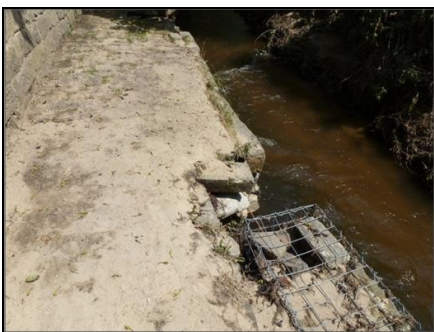
Abb. 5: Nach HW-Ereignis: Bermenausbruch und Sedimentablagerungen im Bereich Prallbogen, 09.10.2018
