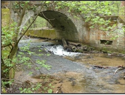
Abb. 2: Bereich "Neue Brücke" nach HW-Ereignis: Ablagerungen, erodierte Sohlbefestigung, Schadstellen im Mauerwerk der Flügelmauern, unterspülte Ufermauer, 09.10.2018
