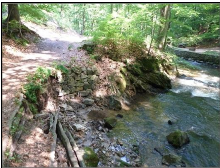
Abb. 4: Nach HW-Ereignis: Böschungsabbruch im Bereich Prießnitzwasserfall, 09.10.2018
