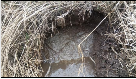
Abb. 2: Vor der Maßnahme: Pflasterung unter Sedimentablage im Bereich RRB B6, 22.03.2018
